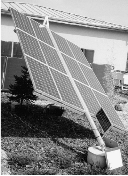
Fig. 5.19. Pequeño sistema fotovoltaico con seguimiento solar.
