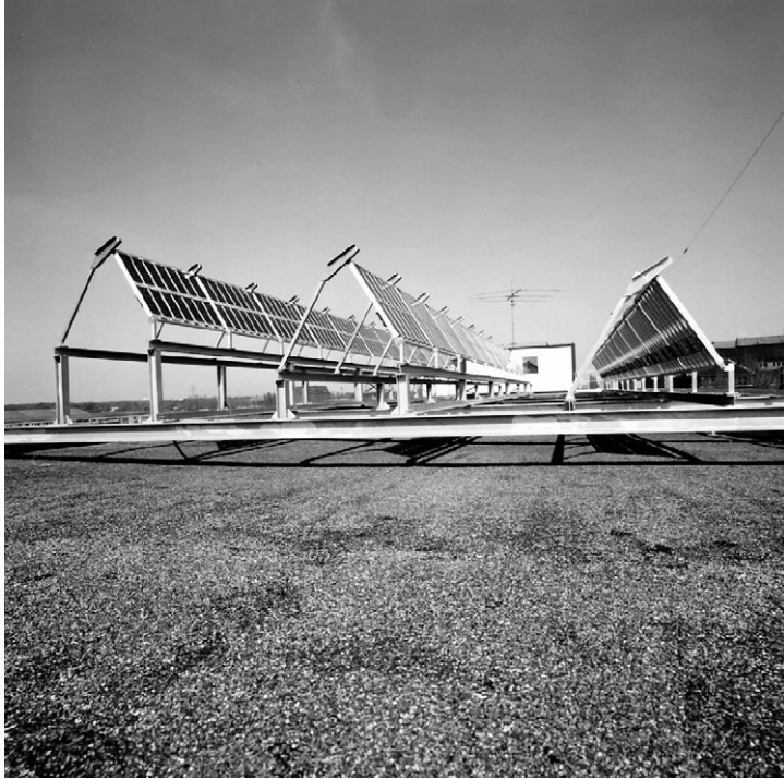
Fig. 5.2. Instalación fotovoltaica que alimenta un equipo transmisor de VHF.
