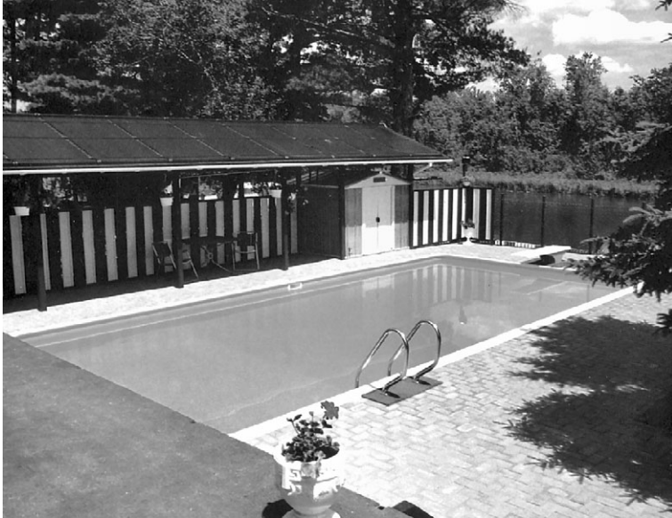
Fig. 4.6. Estos captadores de polipropileno calientan el agua de una pequeña piscina unifamiliar, al mismo tiempo que proporcionan una agradable sombra.
