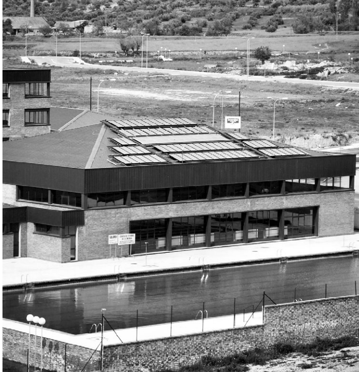
Fig. 3.10. Instalación de captadores planos, que suministra agua caliente a todos los servicios de un polideportivo.
