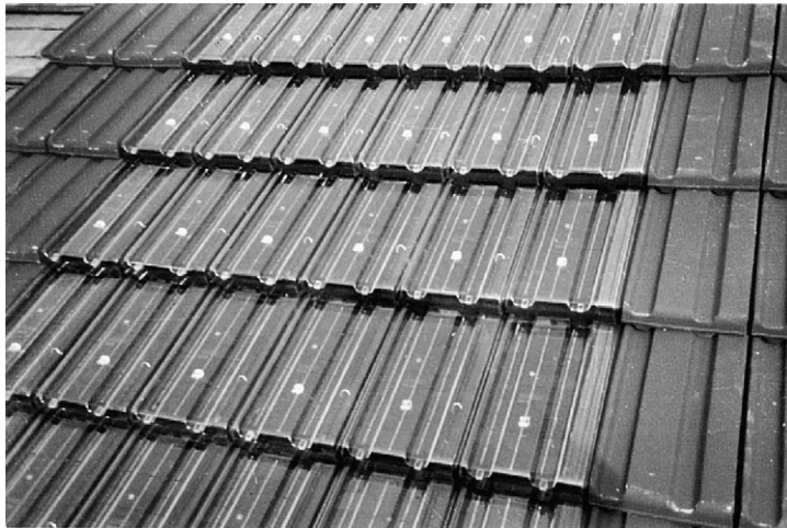
Fig. 5.21. Tejado con tejas fotovoltaicas. Cada teja es un pequeño módulo, de unos 6 vatios de potencia, que sustituye ventajosamente a la teja tradicional, lográndose una total integración arquitectónica. (Cortesía de Europea de Técnicas Ambientales, S.L.).
