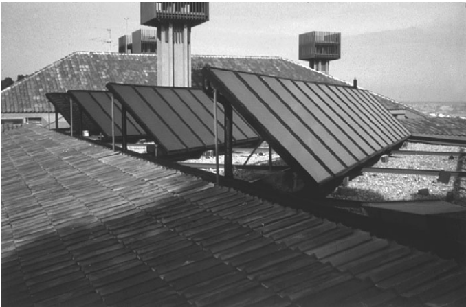
Fig. 3.26. Instalación clásica, en cubierta de edificio, de captadores planos para producción de agua caliente.
