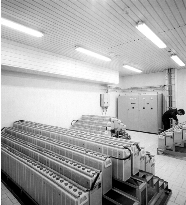
Fig. 3.4. Sala de baterías de una gran instalación.
